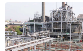
排ガス処理設備(活性炭吸着処理)
