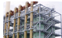
排ガス処理設備(微生物処理)
