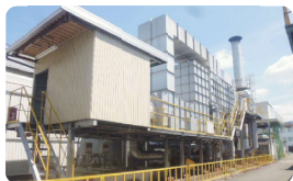
燃焼式脱臭炉
