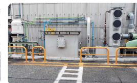
排ガス処理装置
