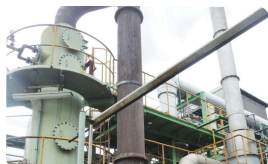
排ガス処理装置
